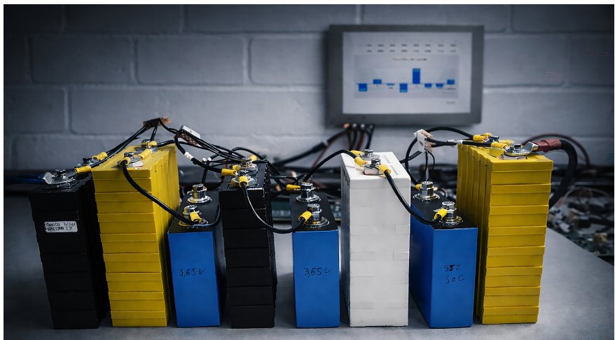
Second-Life mit ETA-Leveling: Gelevelte Zellen aus unterschiedlichen Anwendungen lassen sich einfach in eine neue Anwendung überführen und funktionieren einwandfrei als gemischter Batterie-Block. Foto: Benning CMS Technology
